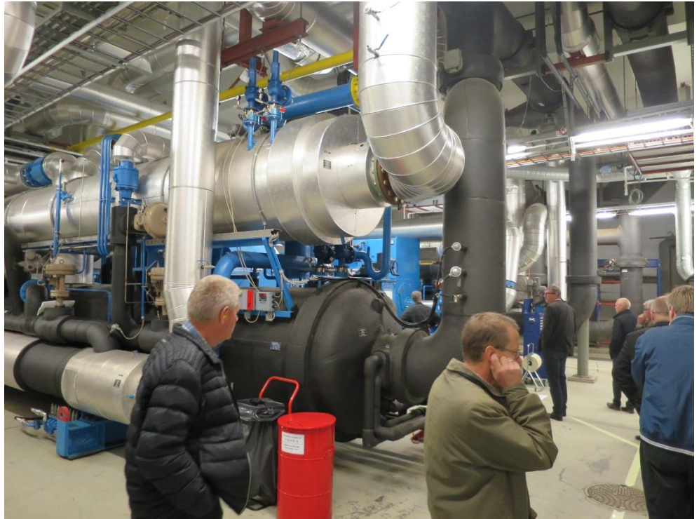
Figur 3; Varmepumpe hos Fornebu Nord Energicentral
