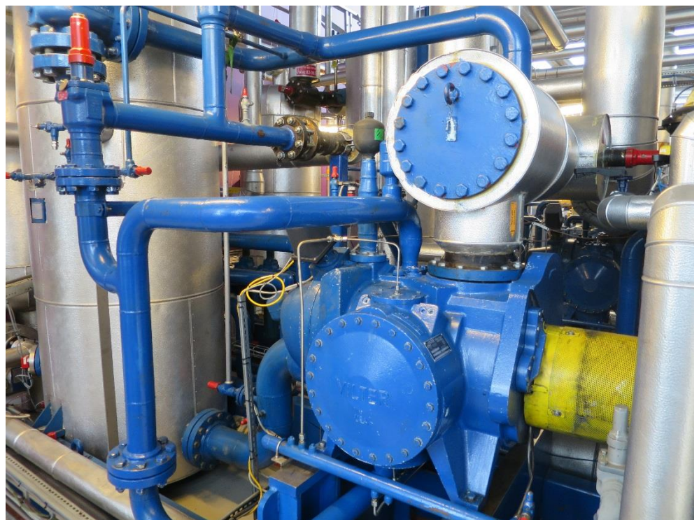
Figur 1; Vilter kompressor hos Drammen Fjernvarme
