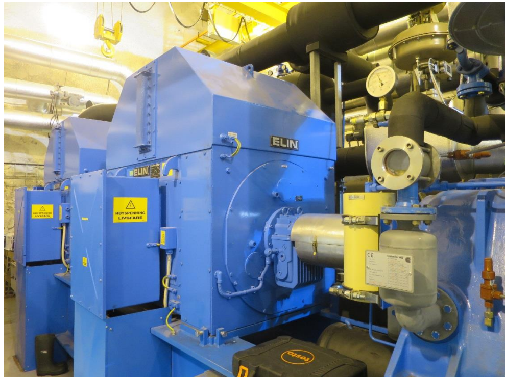
Figur 2; Den ene af tre varmepumper hos Sandvika Energicentral
