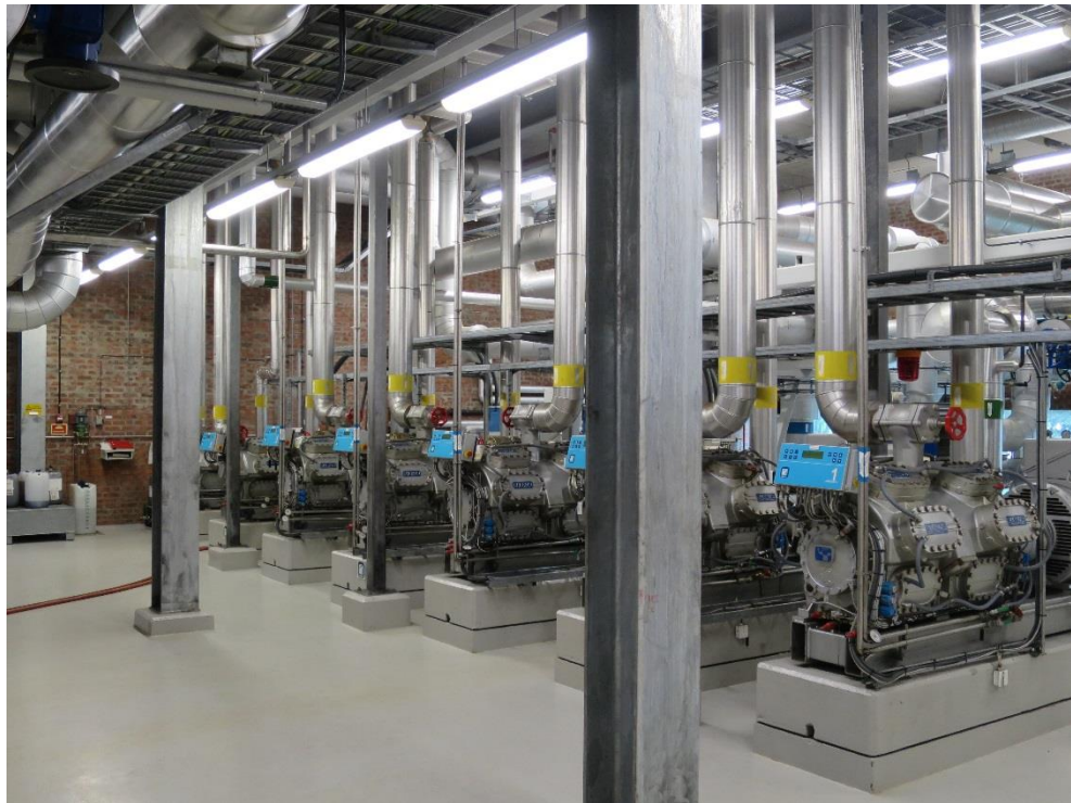
Figur 4; Varmepumpe i Oslo Lufthavn
