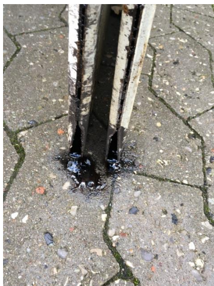
Billede 2 – Væsken fra en ikke oprensede radiator.
