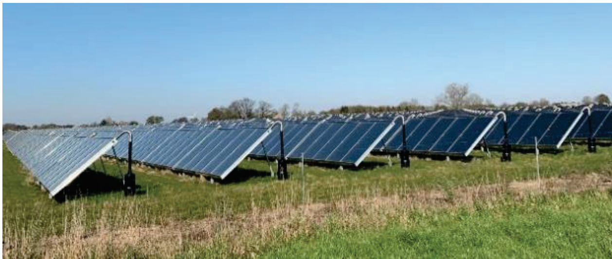
Figur 10 Solvarmeanlæg fra Fuglebjerg Fjernvarme
