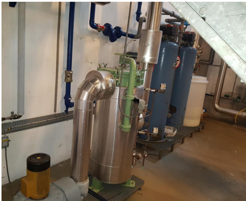
Foto 10 Vandbehandlingsanlæg samt delstrømsfilter
