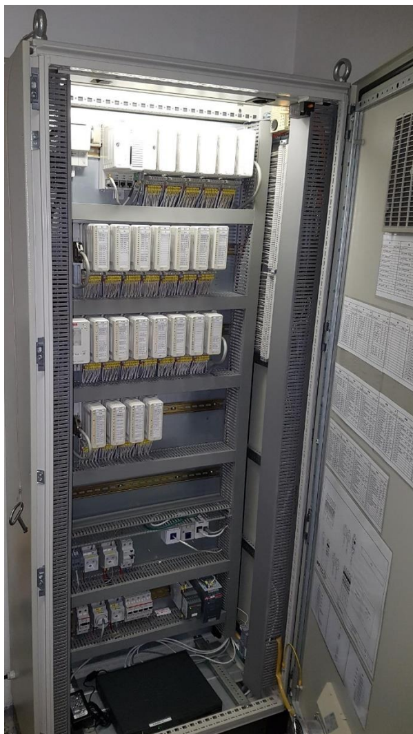
Foto 12 Eksisterende understationstavle baseret på AC800M
